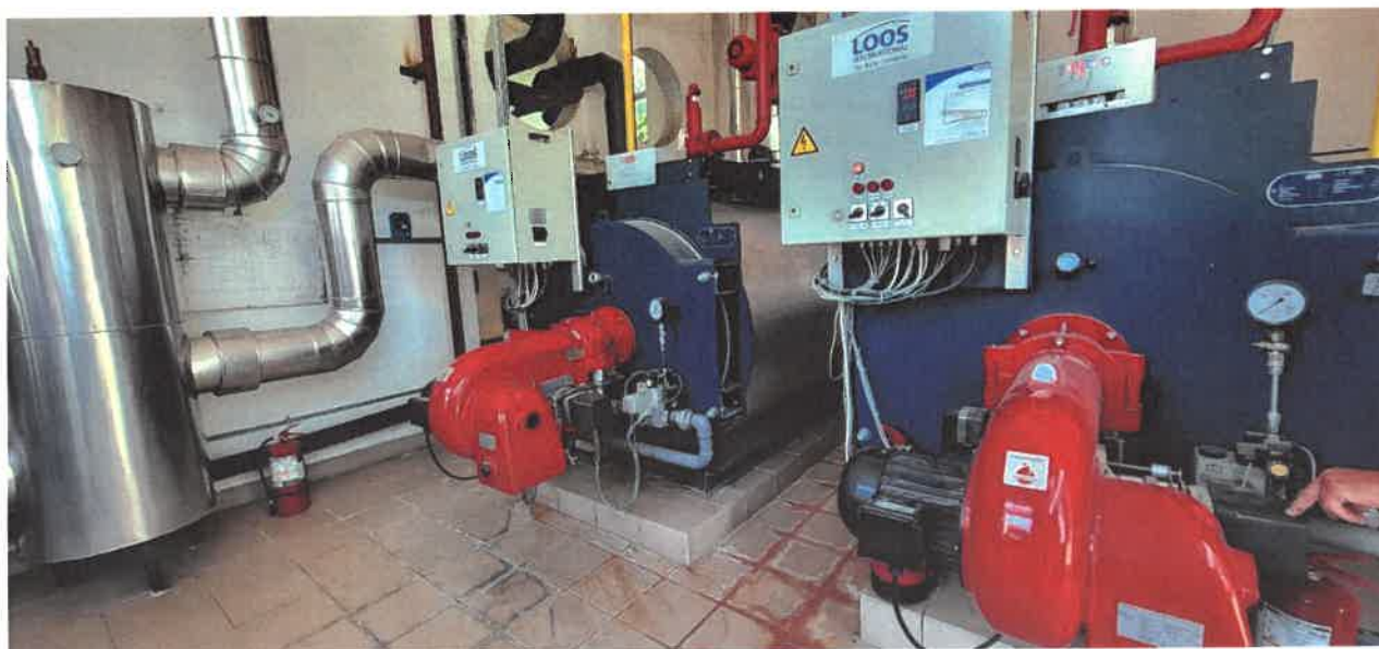
Fig. 2.26. CT 9, echipată cu 2 cazane LOOS tip UT-L 10 x 6 UNIMAT – 1160 kW fiecare
